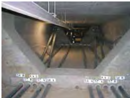
Conductos de PEAD para pretensado exterior
