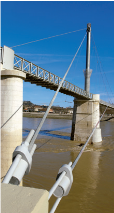
Anclaje de cuerdas de aceros
