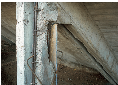
Delaminación del hormigón
