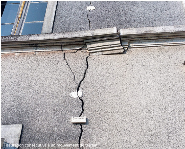
Fissuration consécutive à un mouvement de terrain
