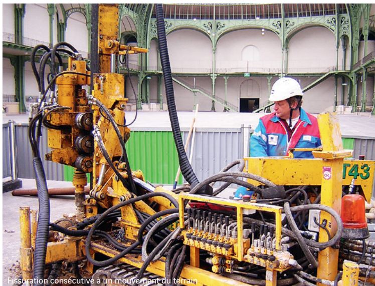
Fissuration consécutive à un mouvement du terrain
